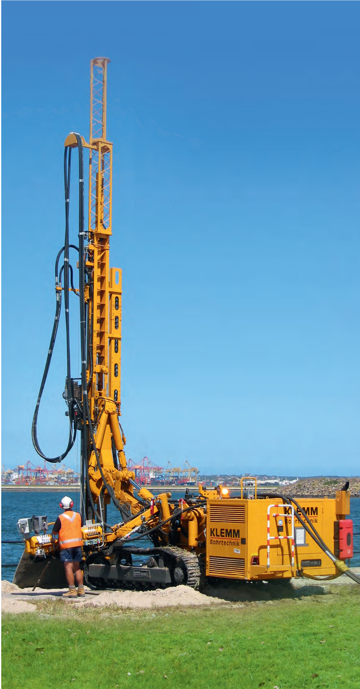
Hochdruckinjektionen High-pressure injections
